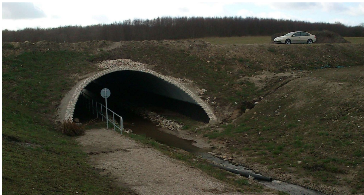
Kombinerad gångtunnel och faunapassage. Foto RhinoMind länk
