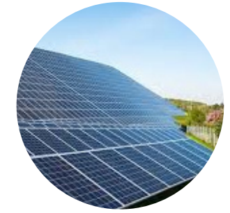
Solceller på tak
