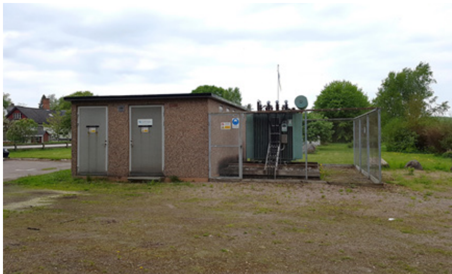
Bild 5. Befintlig transformatorstation, Röstångavägen till vänster i bilden.
