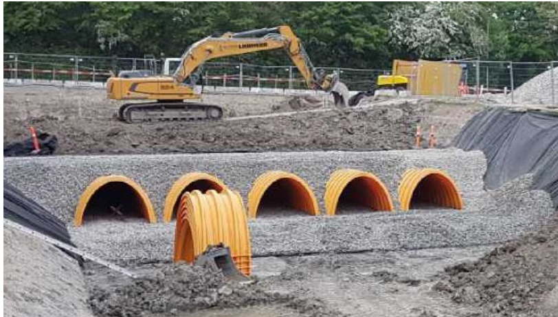
Figur 12: Exempel på underjordiska hästskoformade rörmagasin.
