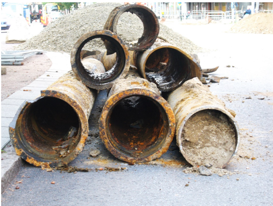
Ledningsnätet åldras och måste förnyas
