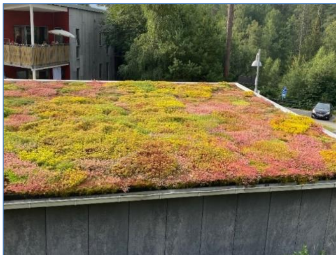
Figur 7-3. Grönt tak av sedum i Lerum (Sweco, 2022).
