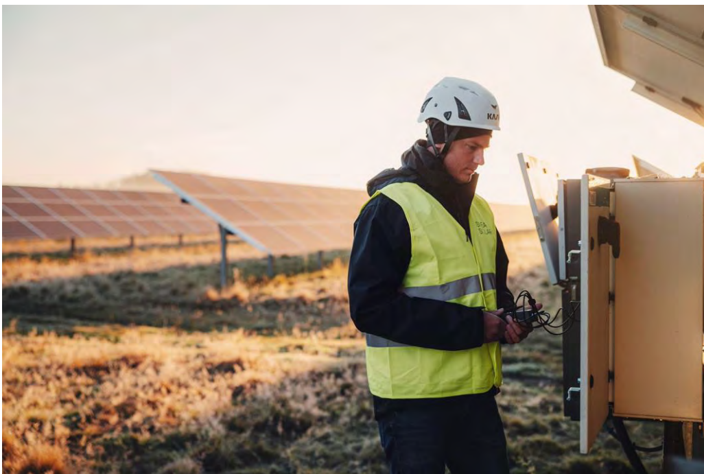
Figur 6. Närbild av växelriktare monterad på montagesystemets baksida (Svea Solar ©).
