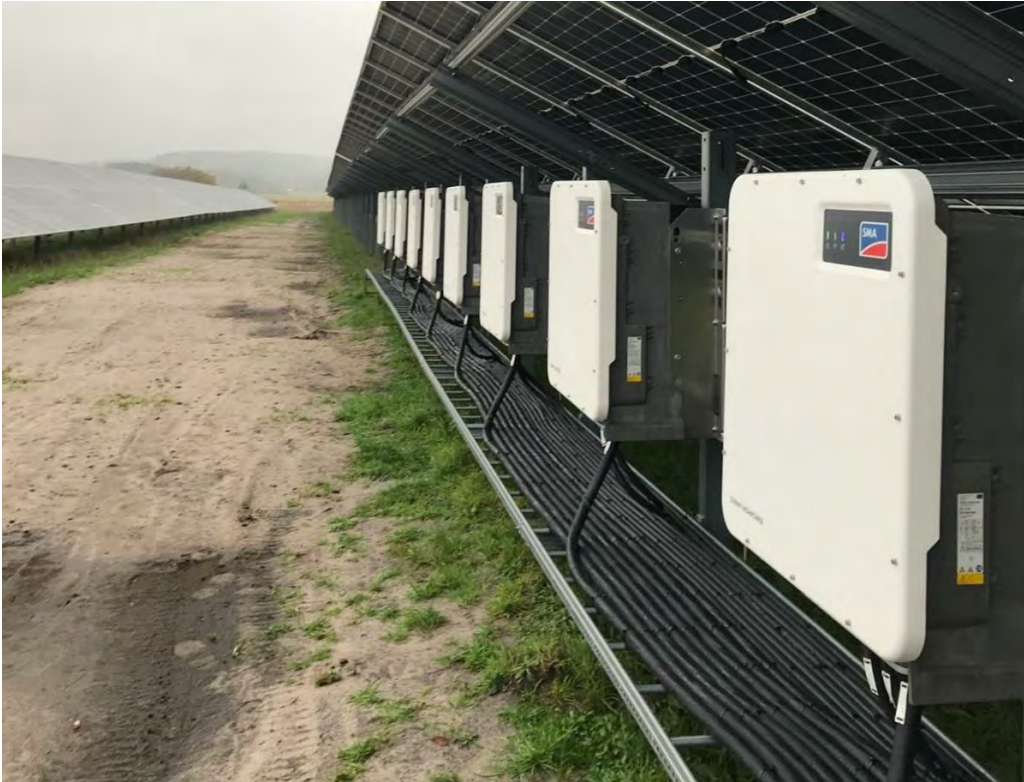
Figur 5. Växelriktare förankrade i markställningen. Bild från Bolagets solcellspark i Sjöbo (Svea Solar ©).
