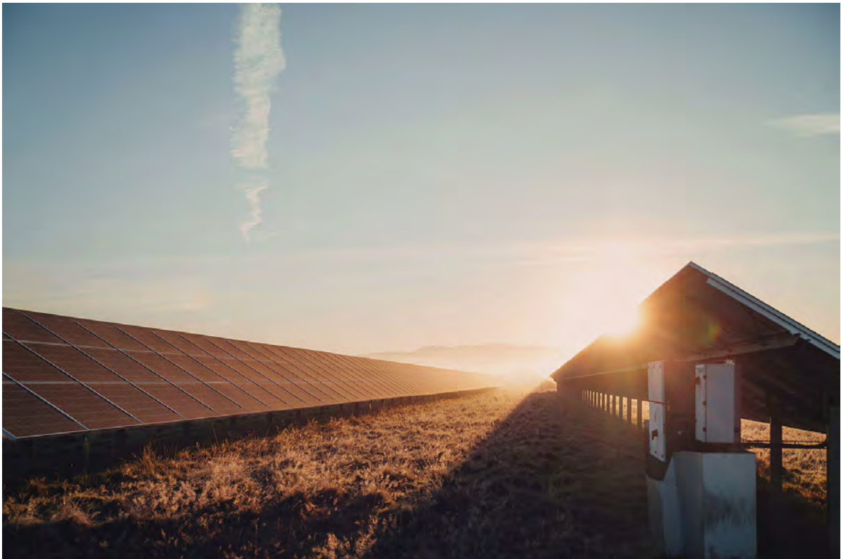
Figur 3. Solpaneler monterade på montagesystem med växelriktare och gnagskydd synligt i högra hörnet (Svea Solar ©).
