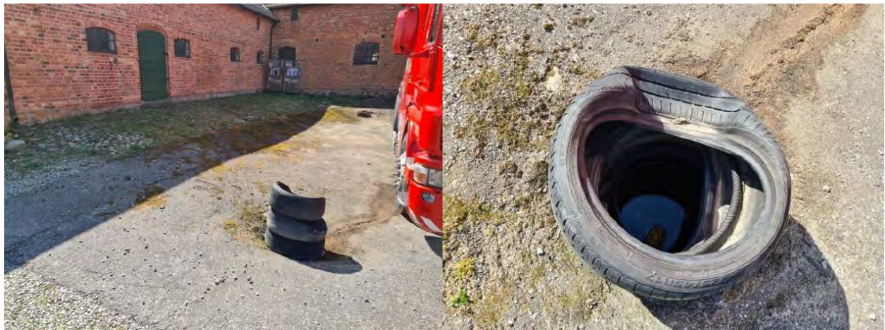
Figur 9 Befintlig dagvattenbrunn, full vid platsbesök men efter fastighetsägaren rensat den låg vattennivån på ca 1,5 m djup
