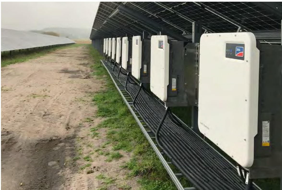
Figur 5. Växeriktare förankrade i markställningen. Bild från Bolagets solcellspark i Sjöbo (©Svea Solar).
