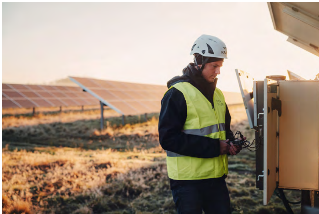
Figur 3.2: Växeriktare monterat till solparkens montagesystem (©Svea Solar).
