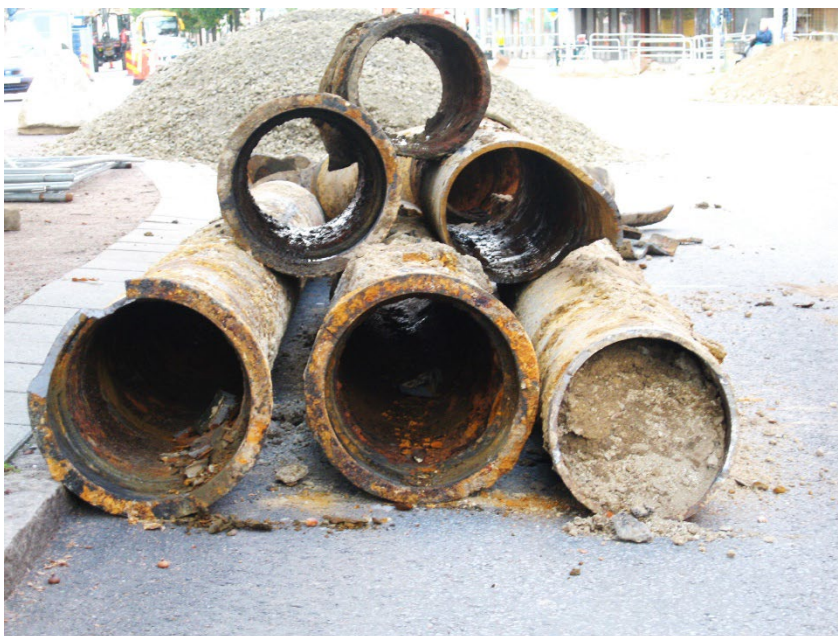
Ledningsnätet åldras och måste förnyas
