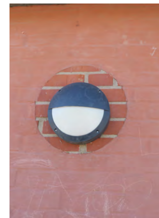
De ursprungligen bara tegelväggarna har senare slammats. Vid fasadarmaturer syns det ursprungliga utseendet.
