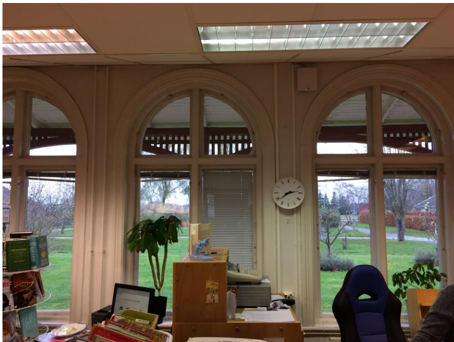
Figur 18 Fönster med bevarade fönsterfoder och fönsterbänkar, november 2017. Notera att undertaket lyfts för att inte skada fönstren.
