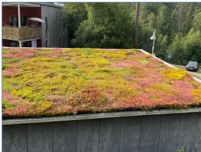
Figur 7-3. Grönt tak av sedum i Lerum (Sweco, 2022).
