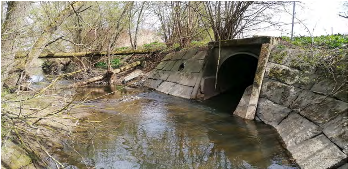
Figur 5.7: Strax öster om Östra Asmundtorp mynnar en kulvert i Långgropen. Kulverten leder dagvatten från stora delar av norra Eslövs tätort till Långgropen.
