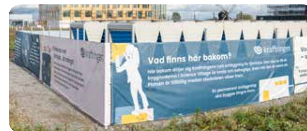
Absorptionskylanläggning på gång i Brunnsnäs.
