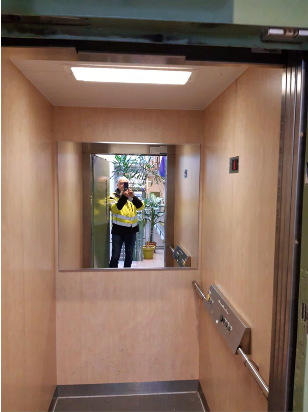
Platsbesök 2024-01-31. Fastigheten Skräddaren 3. Kontroll av utfärdat användningsförbud, enligt besiktningsprotokoll.
