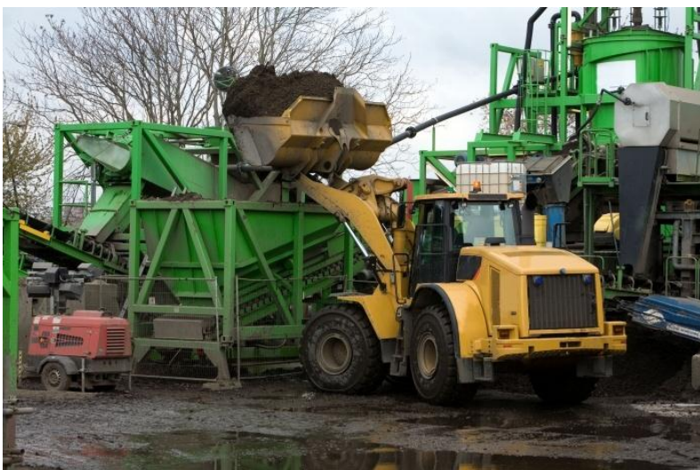
Figur 22: Exempel på jordtvätt-anläggning (bild lånad från London2012.com).
