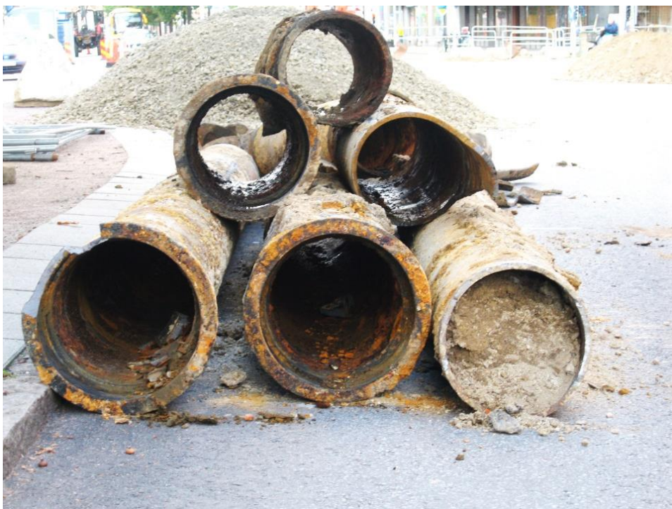
Ledningsnätet åldras och måste förnyas
