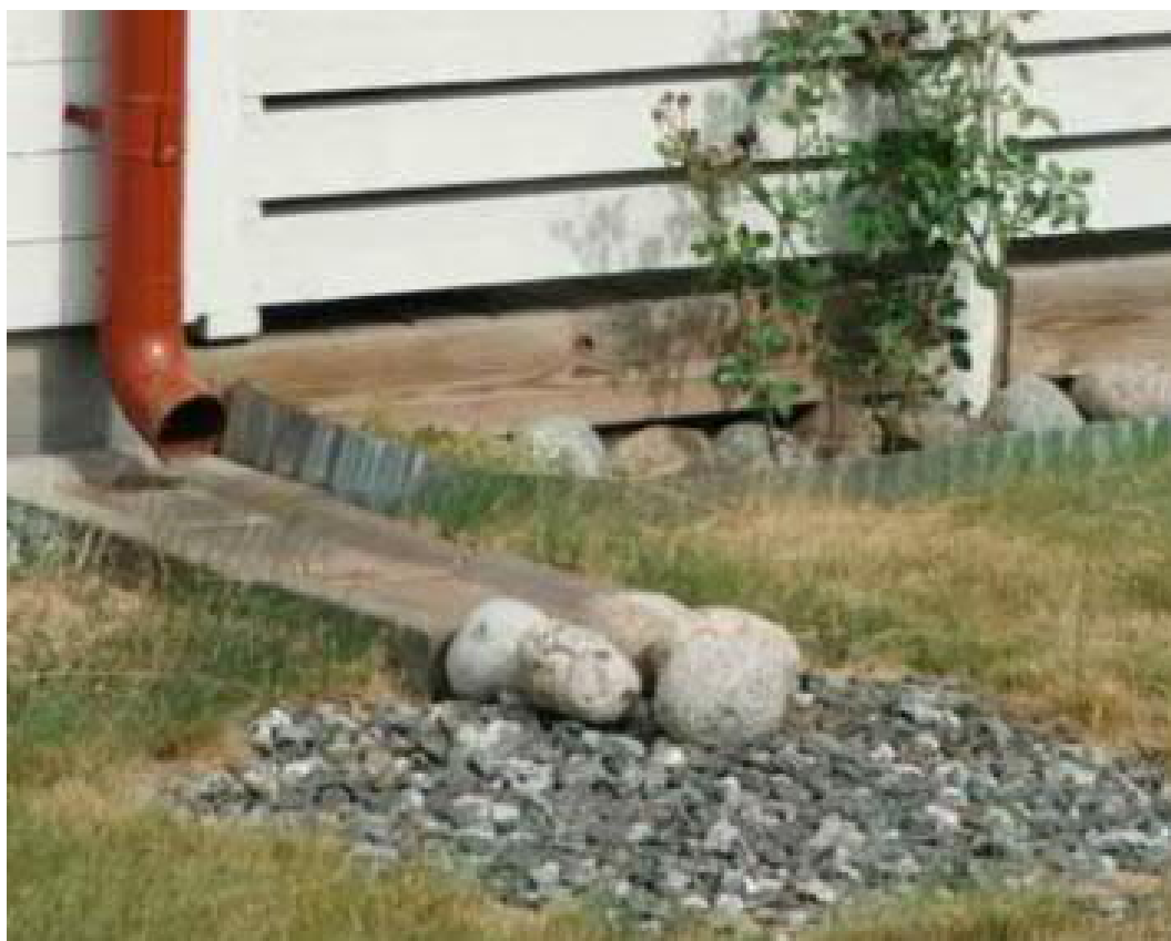
Figur 13: Stuprörutkastare med rännalsplattor och erosionsskydd som leder ut vattnet på gräsmattan. Foto: Dagvattenhandbok, Haninge kommun 2019.
