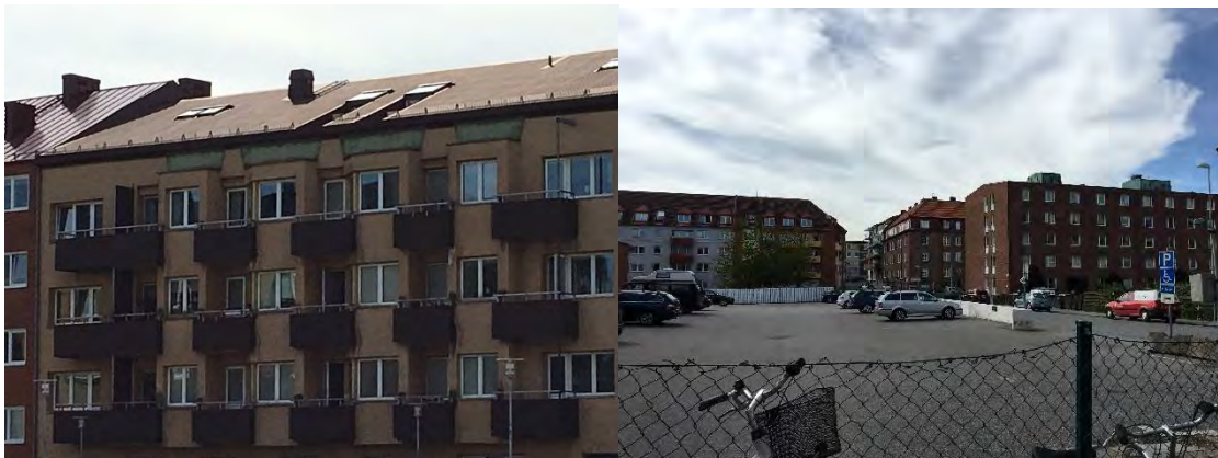
Figur 5. Längs med Kanalgatan finns ett flertal ventilationsutlopp på de olika fastigheterna. Bilderna ovan visar två exempel.
