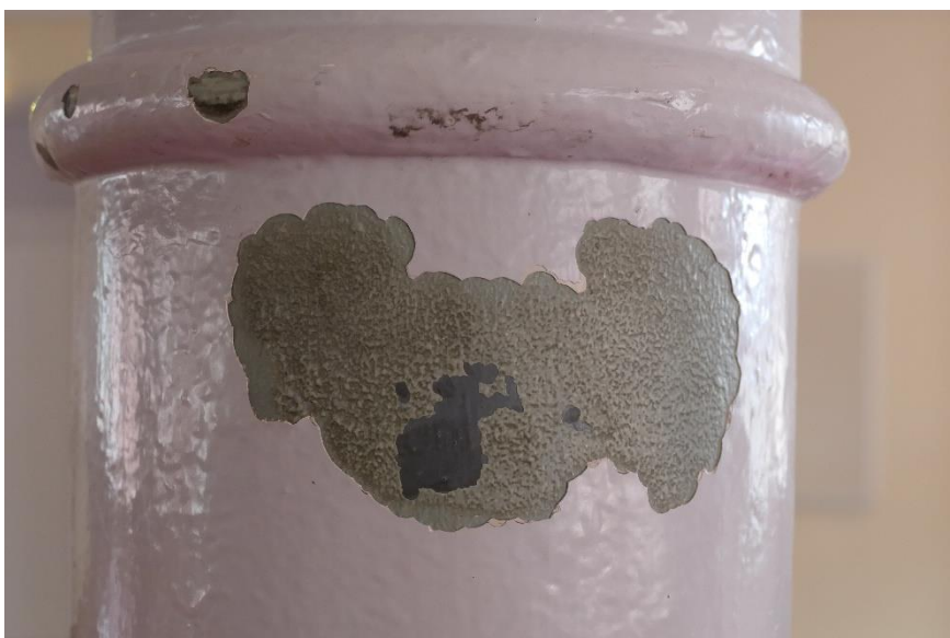
Gjutjärnskolonnen visar tidigare färgskikt i grågrön kulör.
