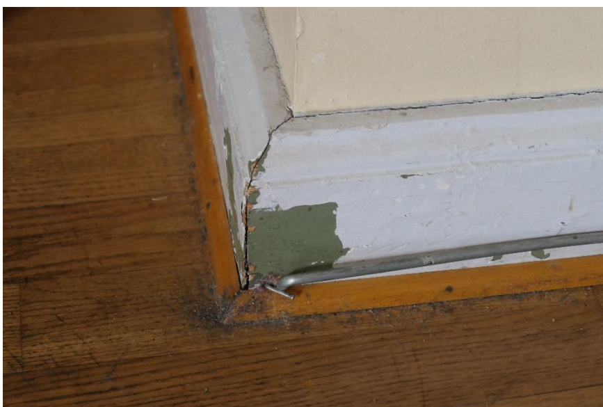
Äldre färglager i grönt på sockellisten i foajén på andra våningen.
