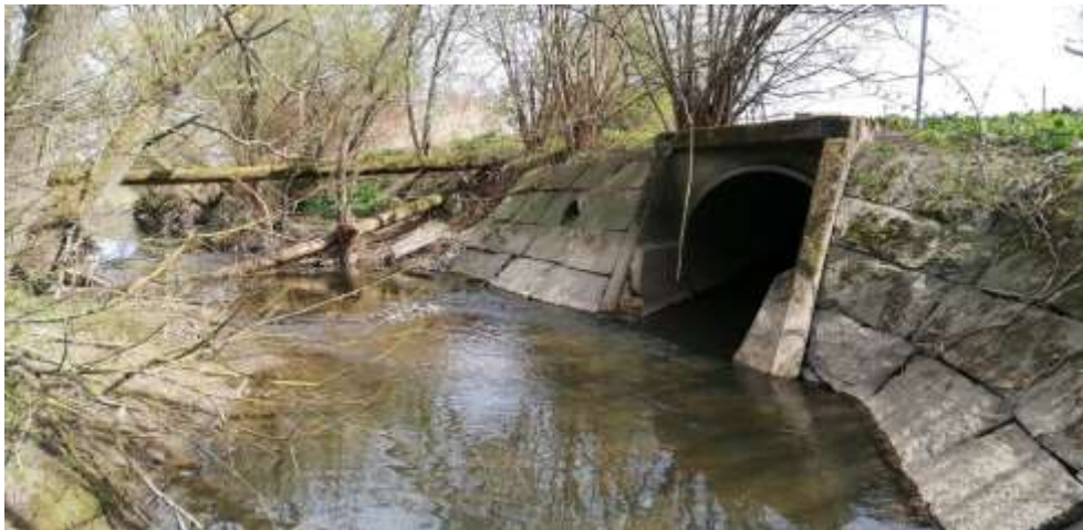
Figur 4.9: Strax öster om Östra Asmundtorp mynnar en kulvert i Långgropen. Kulverten leder dagvatten från stora delar av norra Eslövs tätort till Långgropen.
