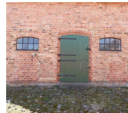
Detalj av norra fasaden, utgång mot gödselstacken. Under fönstren syns igenmurade luckor för grisarna.
