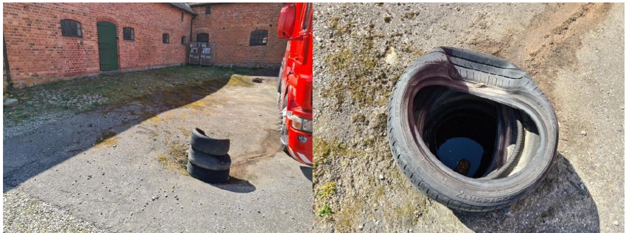
Figur 10 Befintlig dagvattenbrunn, full vid platsbesök men efter fastighetsägaren rensat den låg vattennivån på ca 1,5 m djup
