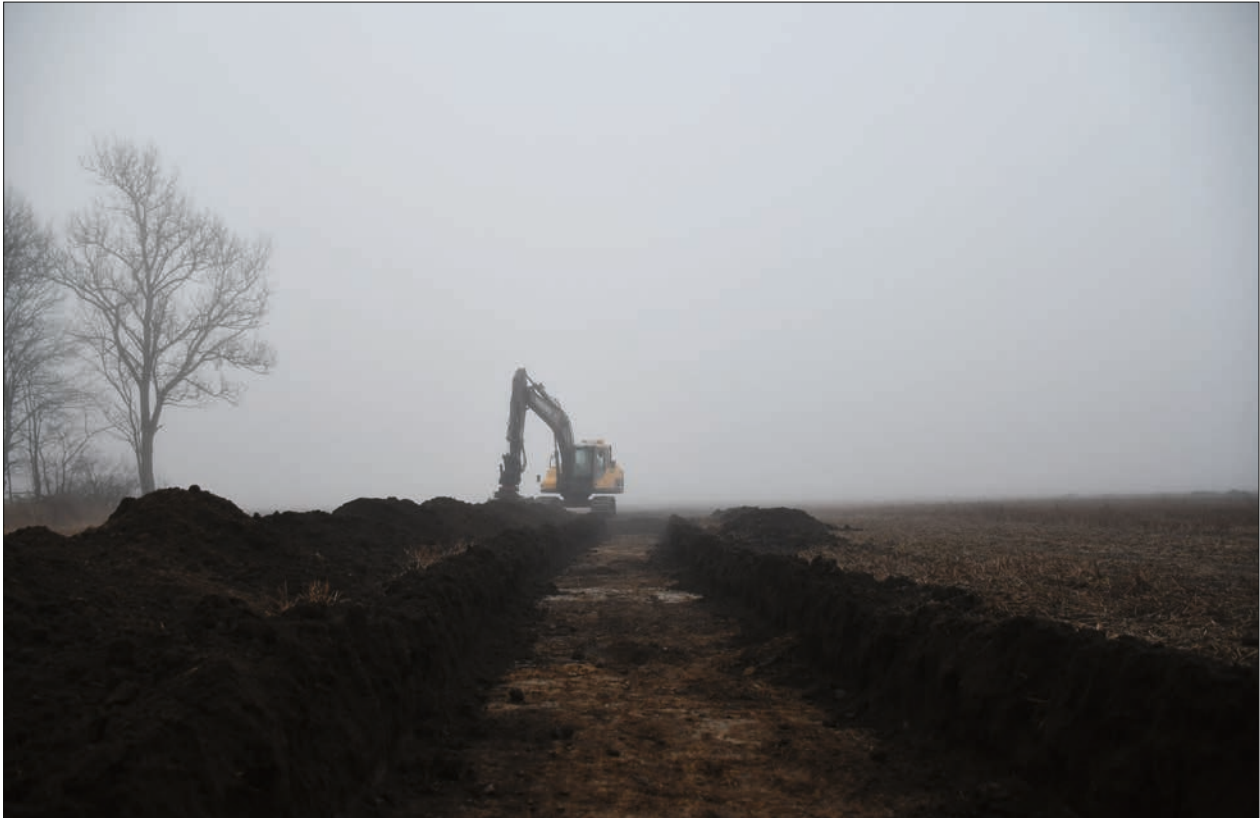
Figur 10. Schakt O204 i tät dimma, sett från norr. Foto: Krister Kåm Tayanin.
