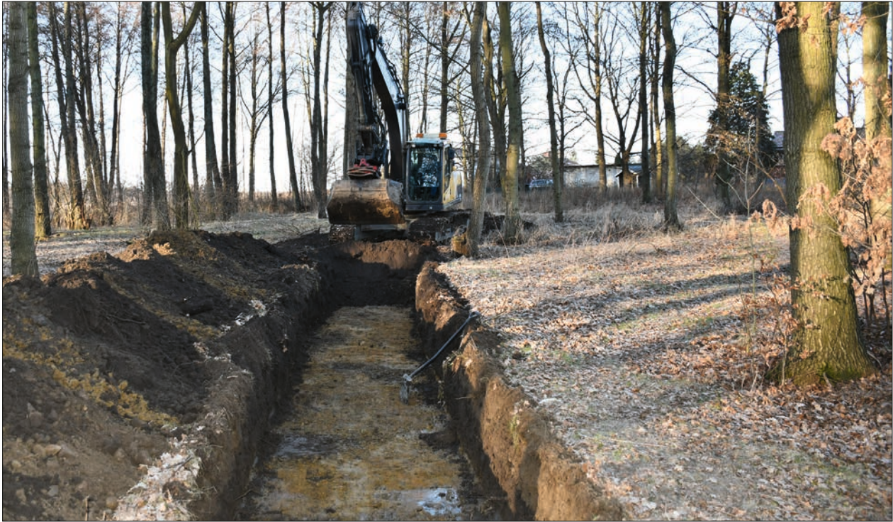
Figur 19. Schakten i dungen blev djupa och fuktiga. På bilden syns schakt O354 sett från öst. Foto: Krister Kàm Tayanin.
