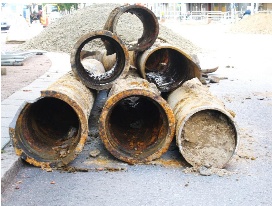
Ledningsnätet åldras och måste förnyas
